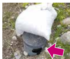
公共汚水ますの破損
