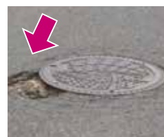
マンホール周囲の舗装破損
