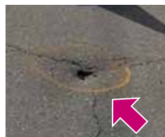
下水道管上の路面陥没
