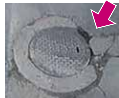
公共汚水ますの破損
