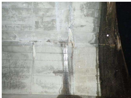
▲漏水（小又沢トンネル）
