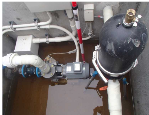
水没したポンプ
