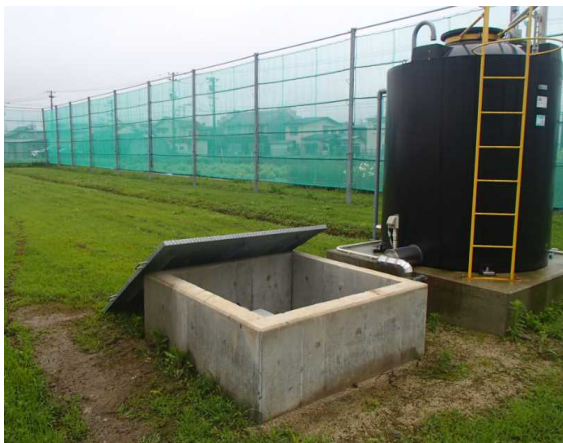
ポンプ槽(外観)
