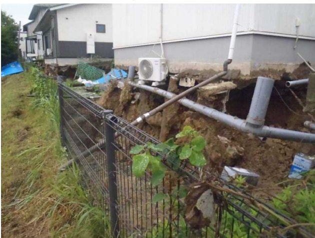
法面崩落状況
