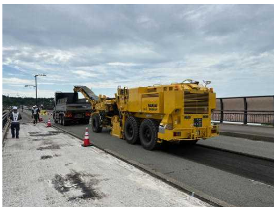
車道切削状況 (R7. 8)
