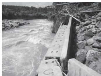
コンクリート水路の崩落（河辺地域）
