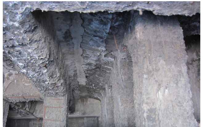
JX日鉱日石エネルギー株式会社 秋田油槽所内 被災建物(倉庫内)
