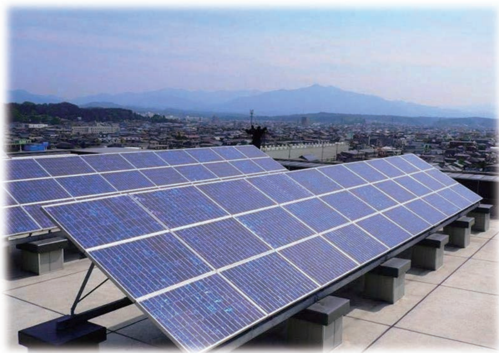
ビルの屋上に設置されたソーラーパネル
