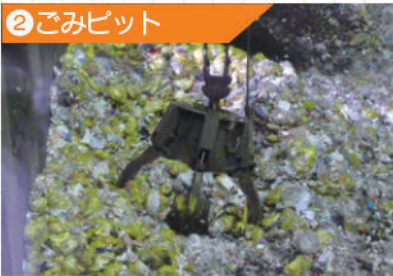
3 ごみクレーン
