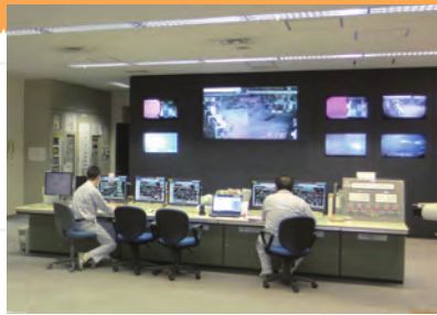
中央管制室 (機械の運転を行います)
