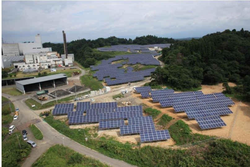
秋田市メガソーラー発電所の全景
