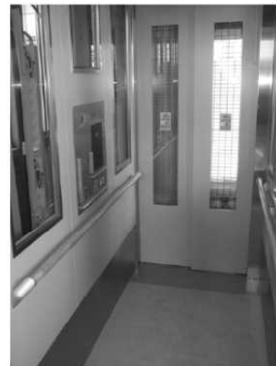
エレベーター室内
