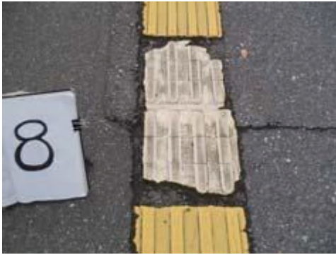
Aルート 8番 (点字ブロックの破損)
