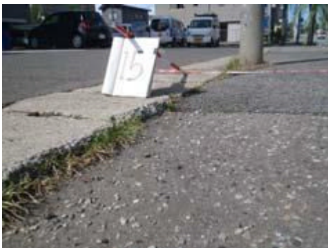
Dルート 15番 (路面と側溝の段差)
