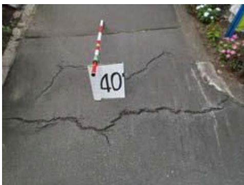
Eルート 40番 (街路樹等の根上がりによる破損)
