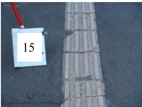
Bルート 15番 (点字ブロックの破損)
