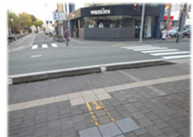
(剥がれている点字ブロック)
