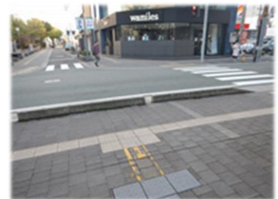
(剥がれている点字ブロック)
