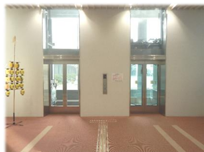
(エレベーター出入口に点字ブロックがない)
