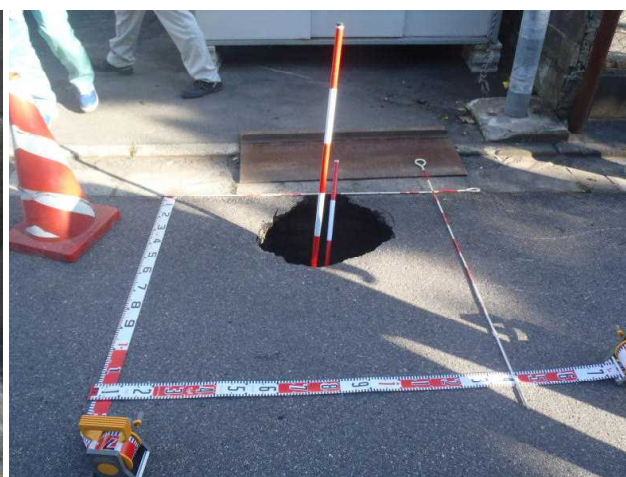
老朽化した下水管による道路陥没
