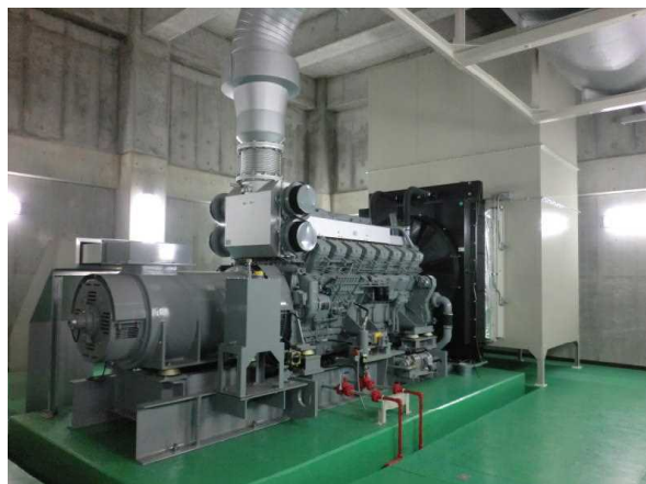
非常用発電設備
