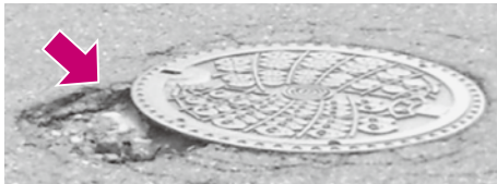
マンホール周囲の舗装破損
