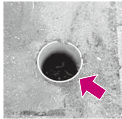
公共汚水ます蓋の紛失
