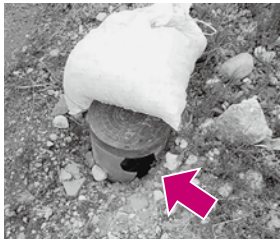
公共汚水ますの破損
