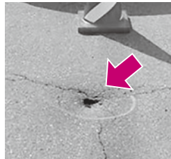
下水道管上の路面陥没
