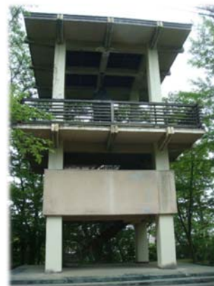
劣化が著しい鐘楼
