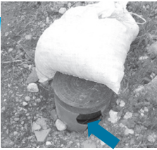
公共汚水ますの破損
