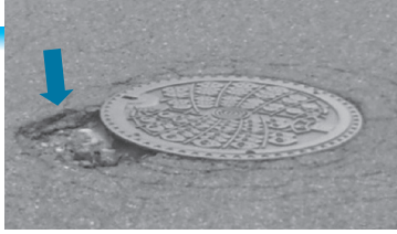
マンホール周囲の舗装破損
