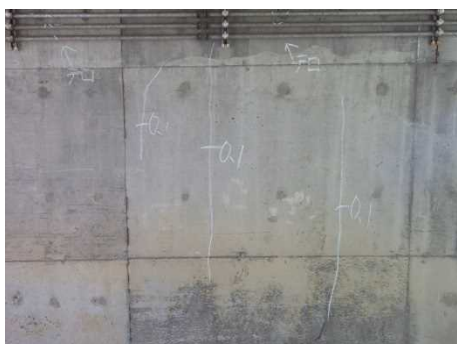
ひび割れ（下河原架道橋）
