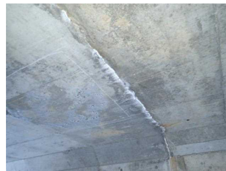
漏水（茱萸野地下道）
