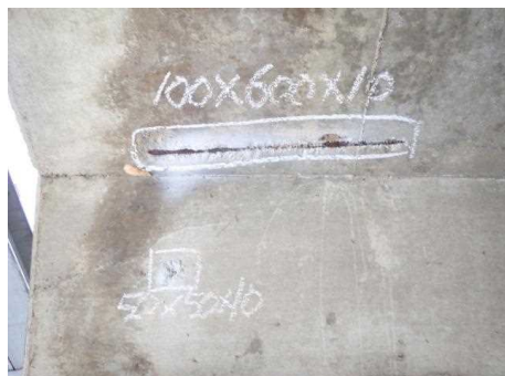
剥離・鉄筋露出（上中野架道橋）
