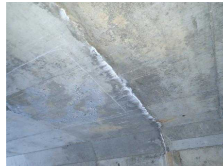
▲漏水（茱萸野地下道）
