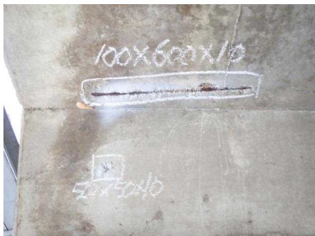
▲剥離・鉄筋露出（上中野架道橋）
