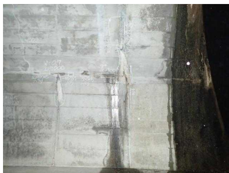
▲漏水（小又沢トンネル）
