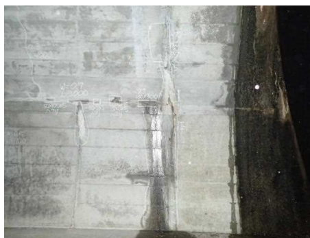
漏水（小又沢トンネル）
