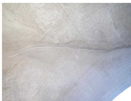
ひび割れ（平尾鳥トンネル）
