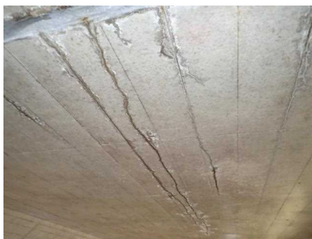
漏水（山手台フォレストパス）
