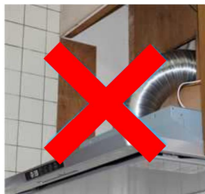
(フレキシブル排気ダクト条例違反)
