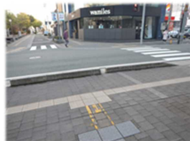
(剥がれている点字ブロック)
