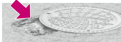
マンホール周囲の舗装破損
