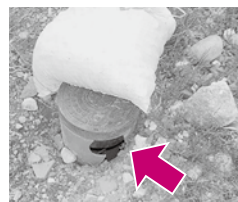
公共汚水ますの破損
