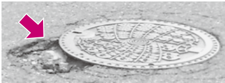
マンホール周囲の舗装破損
