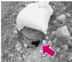
公共汚水ますの破損
