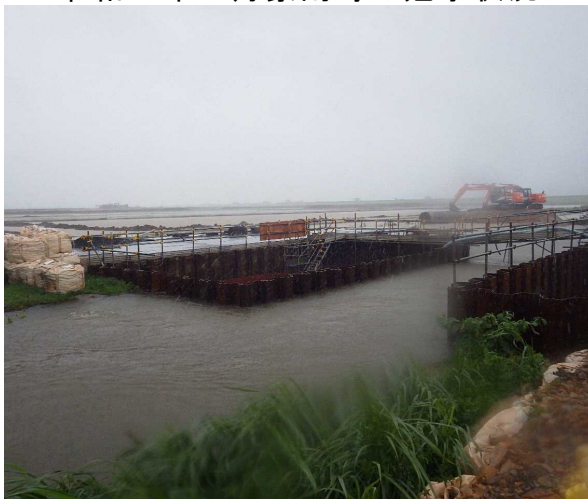
古川増水状況（7月15日8時頃）
