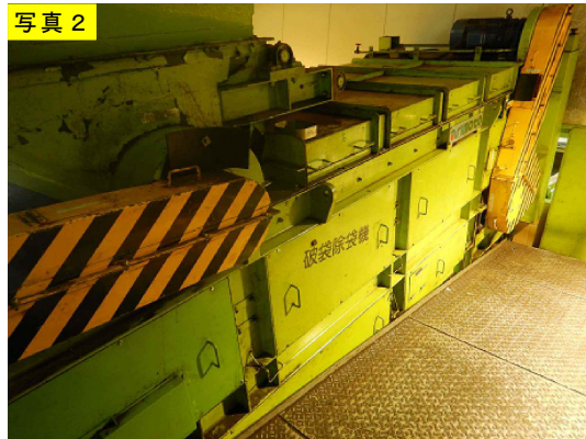
駆動軸等の劣化
