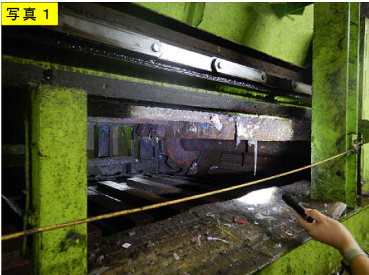
フレーム等の劣化
