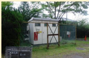
屋外にあった受変電設備
