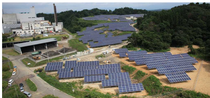
秋田市メガソーラー発電所
