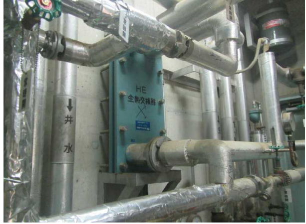
(2) 大型動物舎プレート式熱交換器
