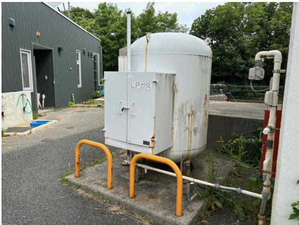
(3) 管理棟ガスバルクタンク
