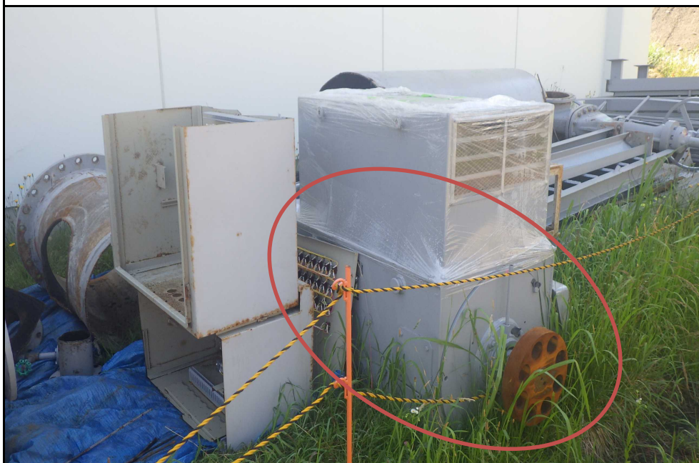
運搬箇所① モーター
