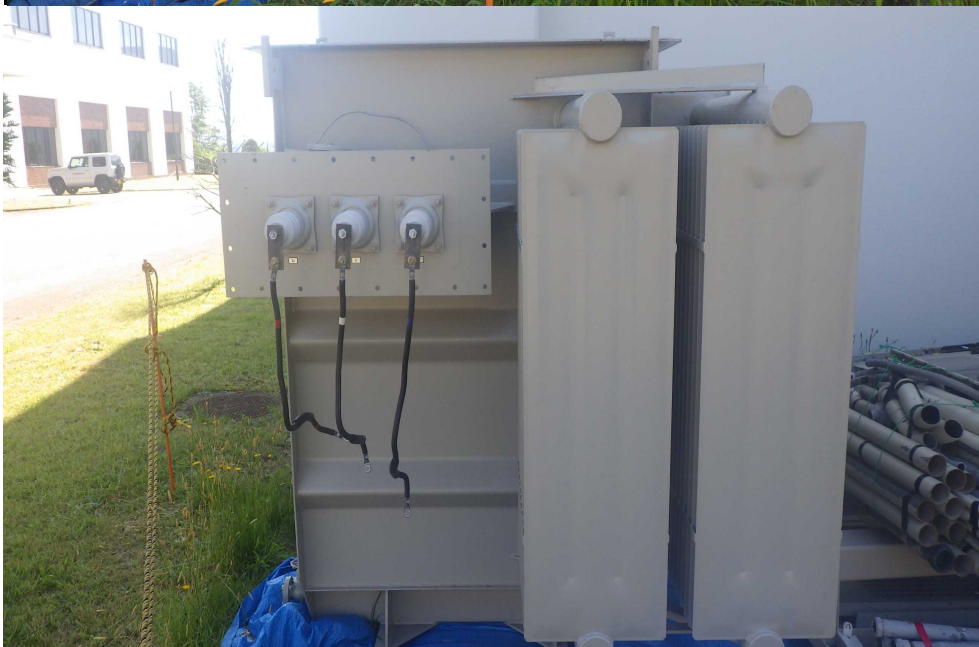
運搬箇所① 変圧器 2,200kg ※抜油済み
